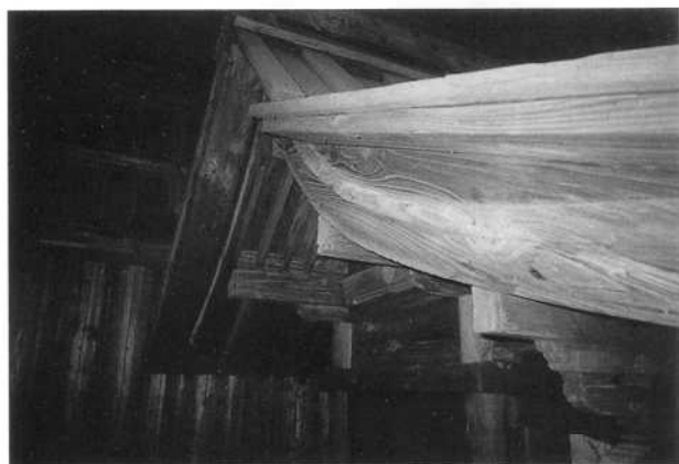
八幡神社本殿 破風板の反り
